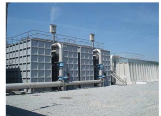
Filtres i Dipòsit aigua tractada
