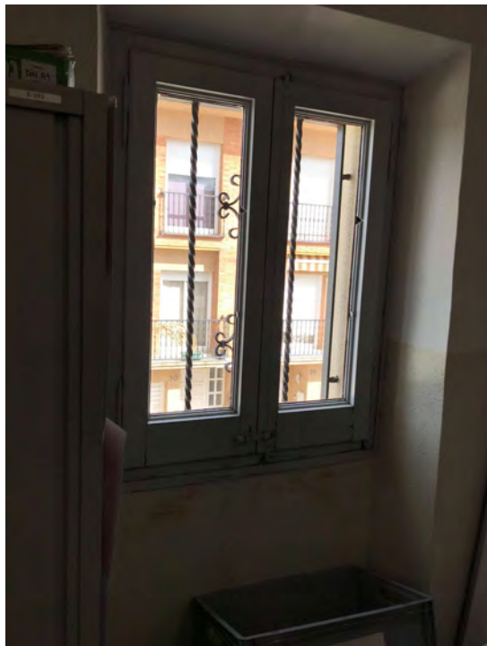
Finestra a substituir F1.Planta primera. Despatx mobilitat i protecció civil
